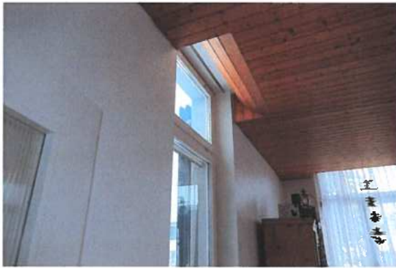
Individuelles Fensterdetail mit abgehängter Decke im EG
