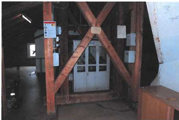
Uhrwerk im Estrich
